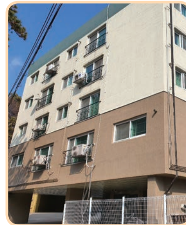
▲ 금릉동 빌라 (고양파주 LH임대주택 M/W외단열)
