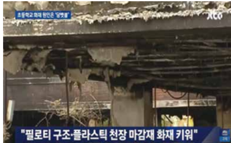
▶ 2019.06.26 서울은명초 화재사고 불이 쉽게 옮겨붙는 필로티구조와 가연성 마감재로 인해 화재 확대
